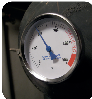
Alla pannor bör ha rökgastermometer.
